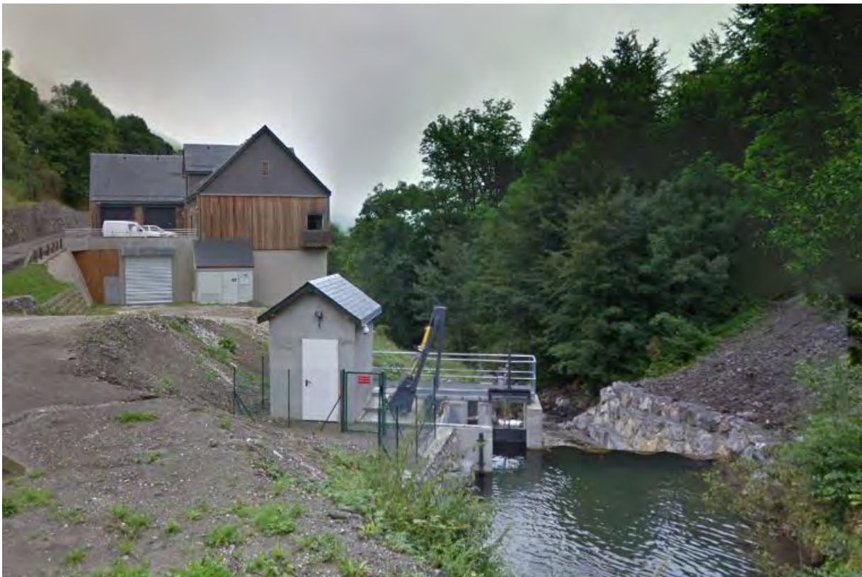
Photo 100 : Station d'épuration de Gouaux-de-Larboust, non conforme en équipement et en performance en 2019, rejetant dans le Goute de Courbe – Source : Google street View
